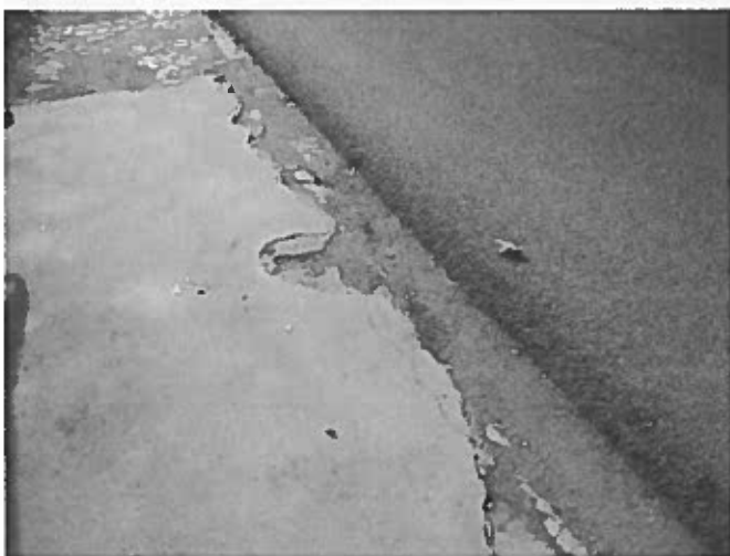
Degradace povrchu pravé římsy, převýšená vozovka
